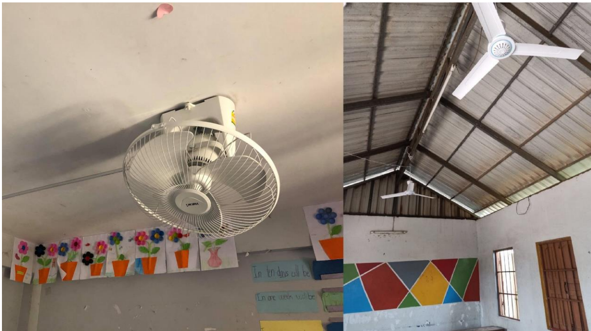
Abb. 2: Neue Ventilatoren in der Schule. Räume mit hohen Decken (rechts) benötigen andere Modelle.
